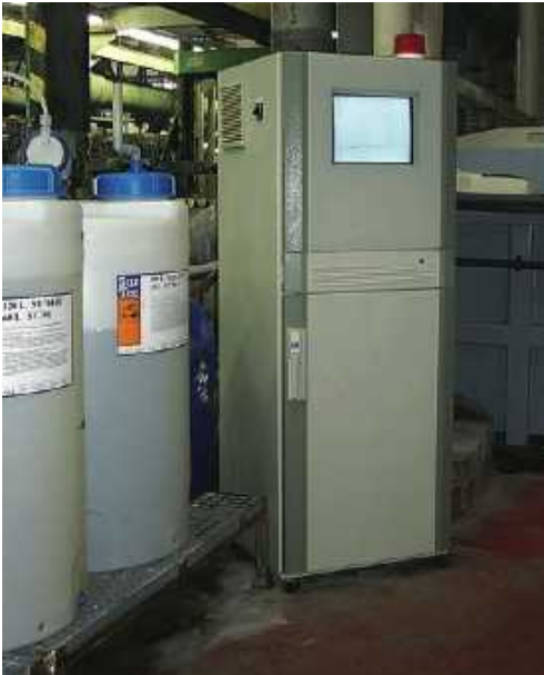
Abb. 2: Der erste installierte ZinkOperator wurde 1999 an der Gestellanlage einer Lohngalvanik im Rahmen der kompletten Umstellung von cyanidischer auf cyanidfreie alkalische Verzinkung installiert
